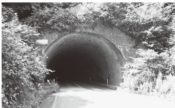
「照明のない白沢トンネル」
